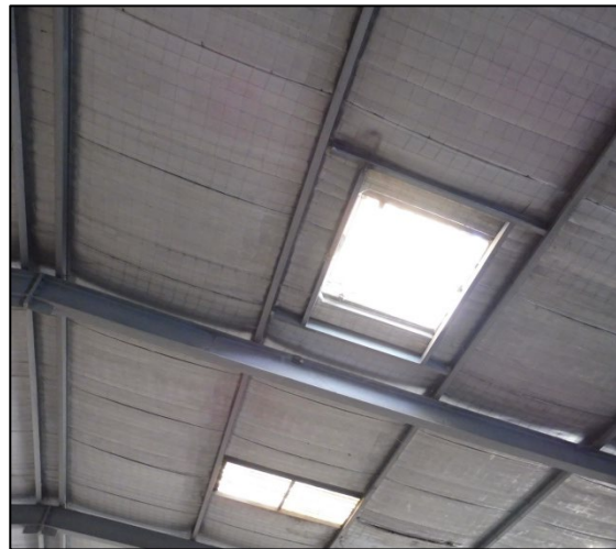
Figure 15. Charpentes et trappes de désenfumages
